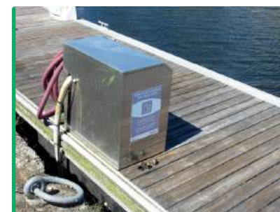
pompes à eaux noires (port de Morlaix)
